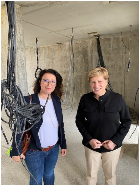
Ayla Cataltepe (links) zusammen mit Nicole Razavi (Mdl) auf der Baustelle in Göppingen.
